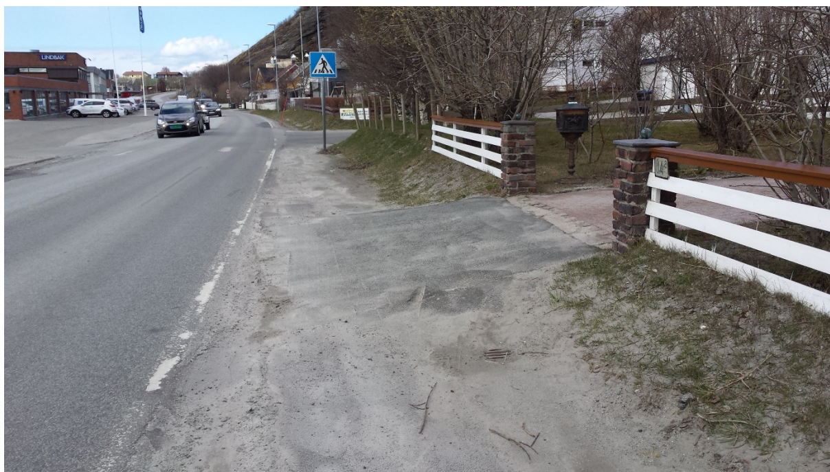
Figur 24: Nedstøvet og nesten helt gjentettet overvannssluk
