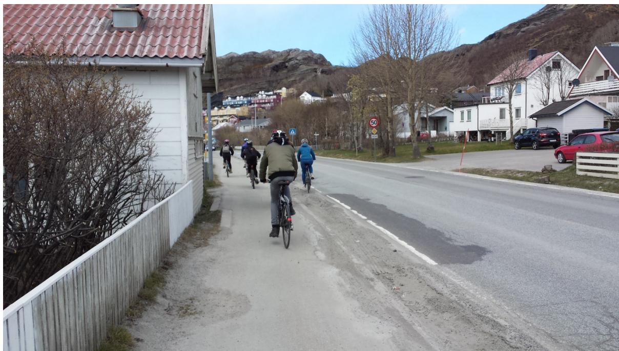
Figur 23: Nedslitt betongkantstein, utslitt/repåret dekke både på fortau og i kjørebanelen
