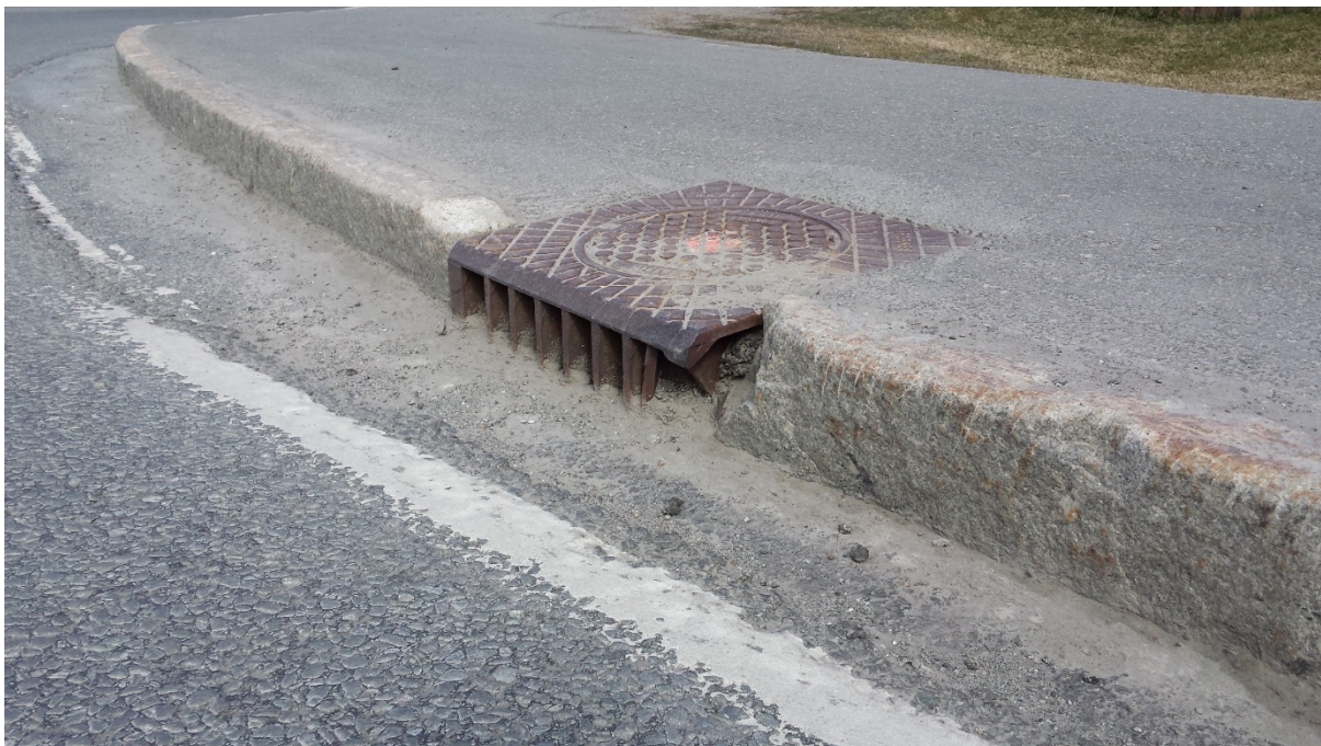
Figur 25: Skadet kjeftsluk og sliten granittkantstein i krysset med Amtmann Worsøes gate, som ble ombygget
